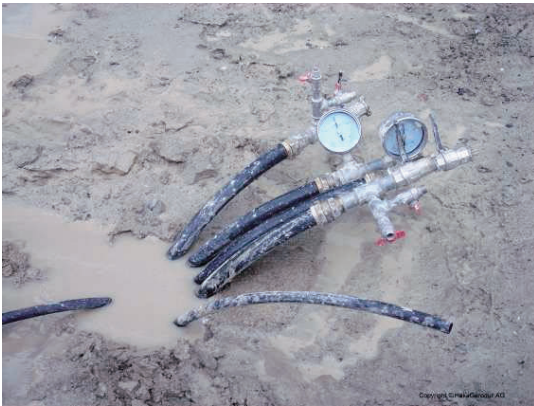
Abbildung 9: Hinterfüllte Erdwärmesonde mit Manometer zur Druckkontrolle [24]
